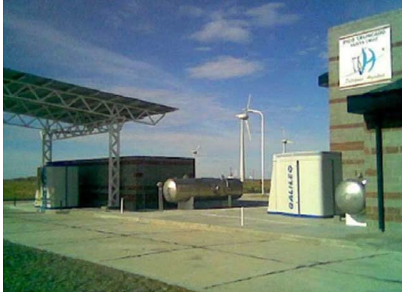
Figura 4.7a,b – Planta Experimental de Hidrógeno – Vista de playa de compresores y tanques Fines 2005
