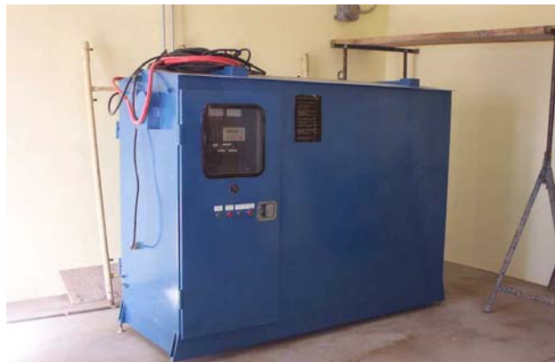
Figura 7.1 – Electrolizador de KOH Stuart de 5kW –instalado en Planta H2 / Pico Truncado
