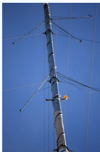
Fig. B Anemómetros rotos Cables cortados Falta una baliza
