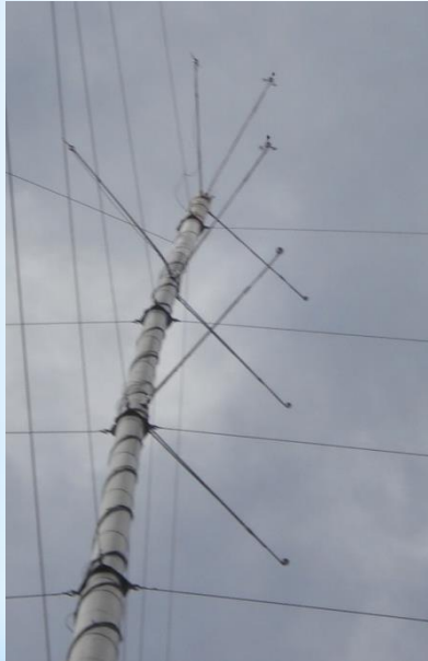
Fig. A Torre torcida Anemómetros rotos
